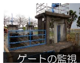
排水機場の監視・制御
