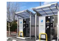
EVバス充電設備
