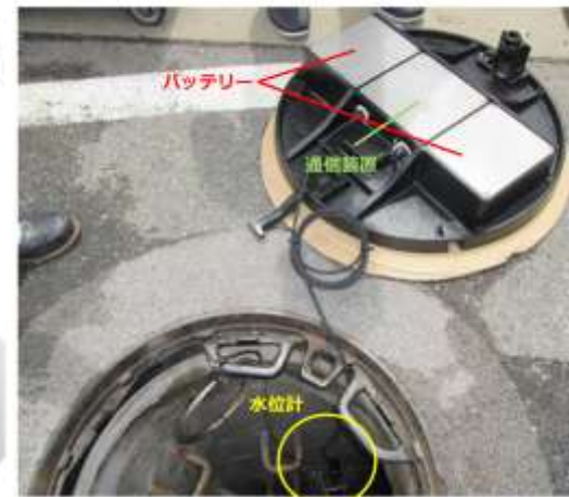
マンホールアンテナ取り付け例
