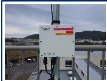
中継子局1台(飯盛中学校 屋上)
