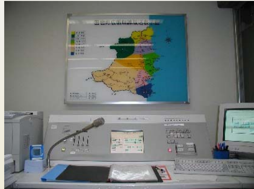
防災行政無線の総合事務所側操作卓
