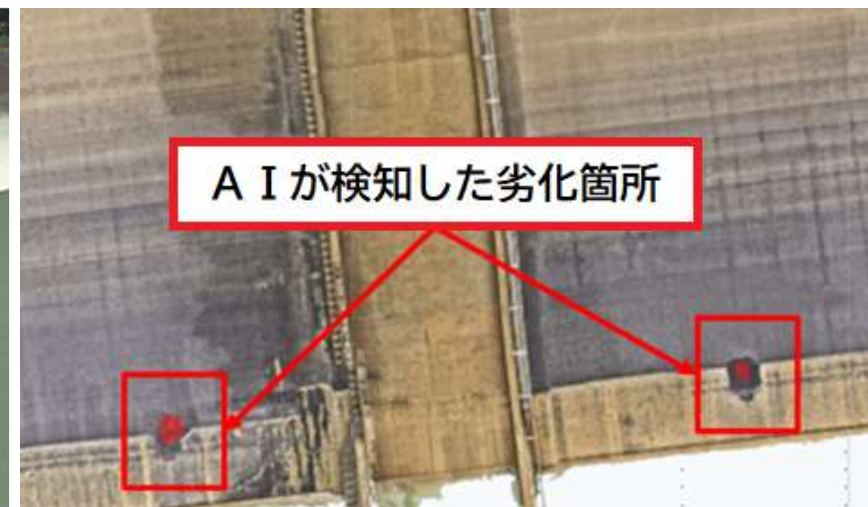
オルソ化した画像をAIで解析し、劣化箇所を色分けした図
