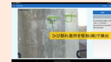
ドローンを活用ひび割れ検出 (広島県立大)
