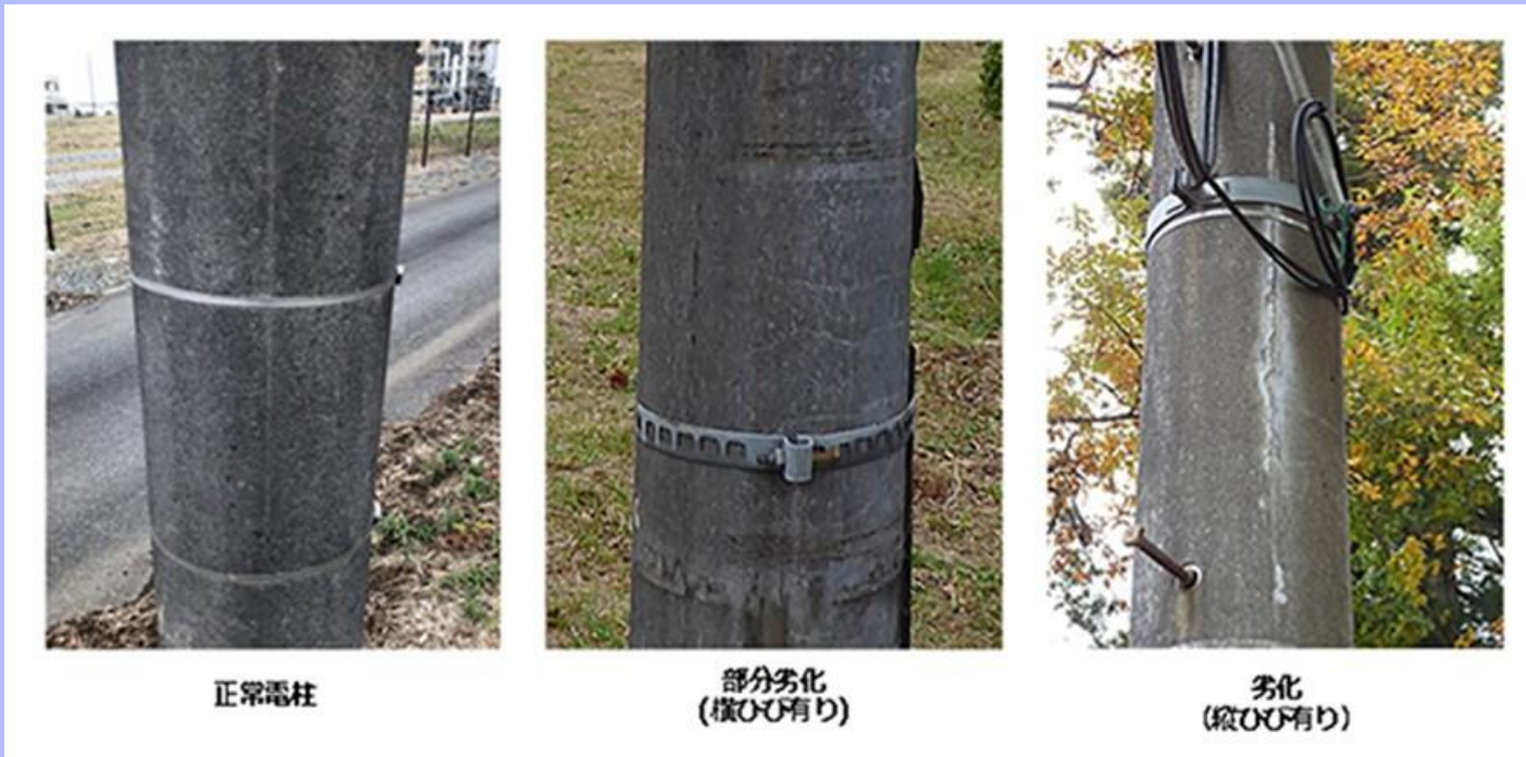
正常電柱と劣化電柱の比較
