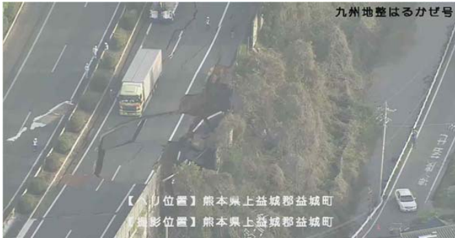
▲ 九州自動車道の陥没
