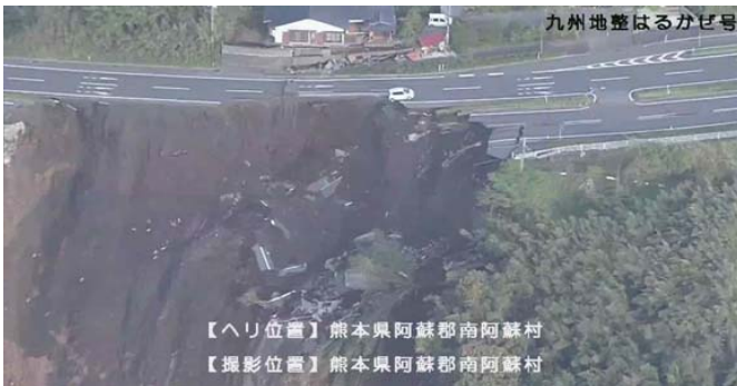
▲ 大規模な道路崩壊 車両や家屋が二次被害
