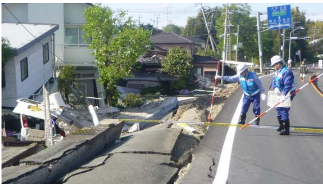
▲ TEC-FORCEが道路の被災状況を調査
