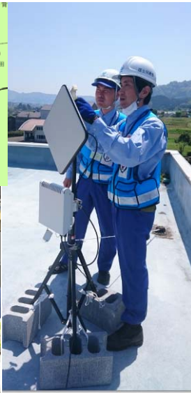
i-RAS設置状況 (熊本河川国道事務所)
