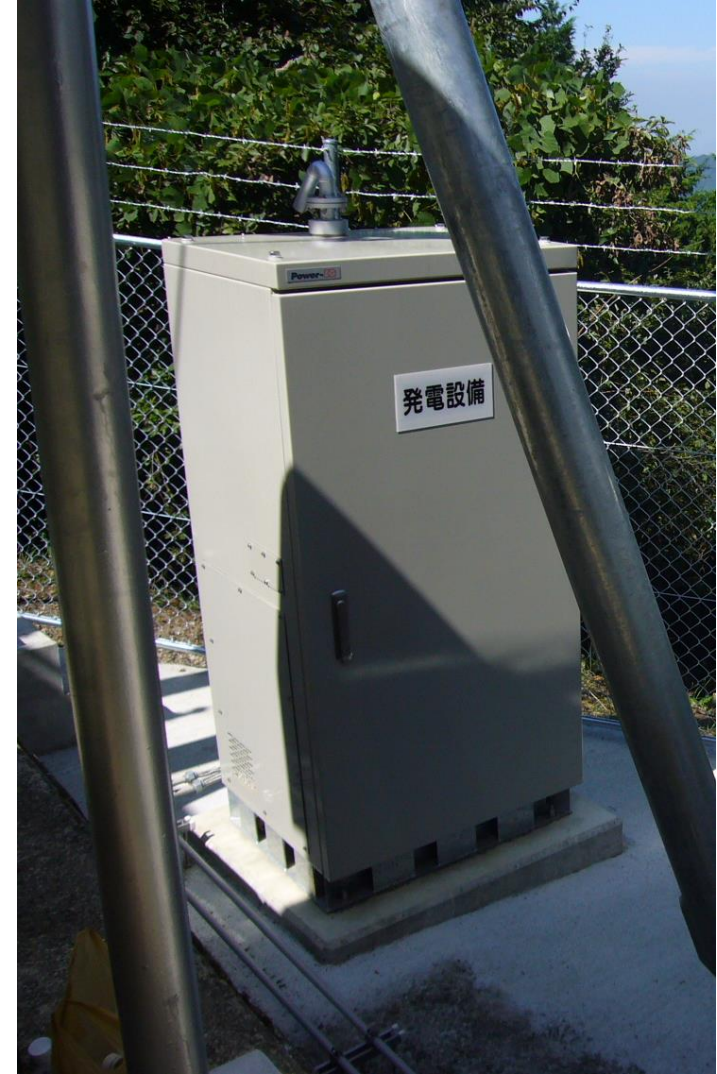
民放共用発電設備
