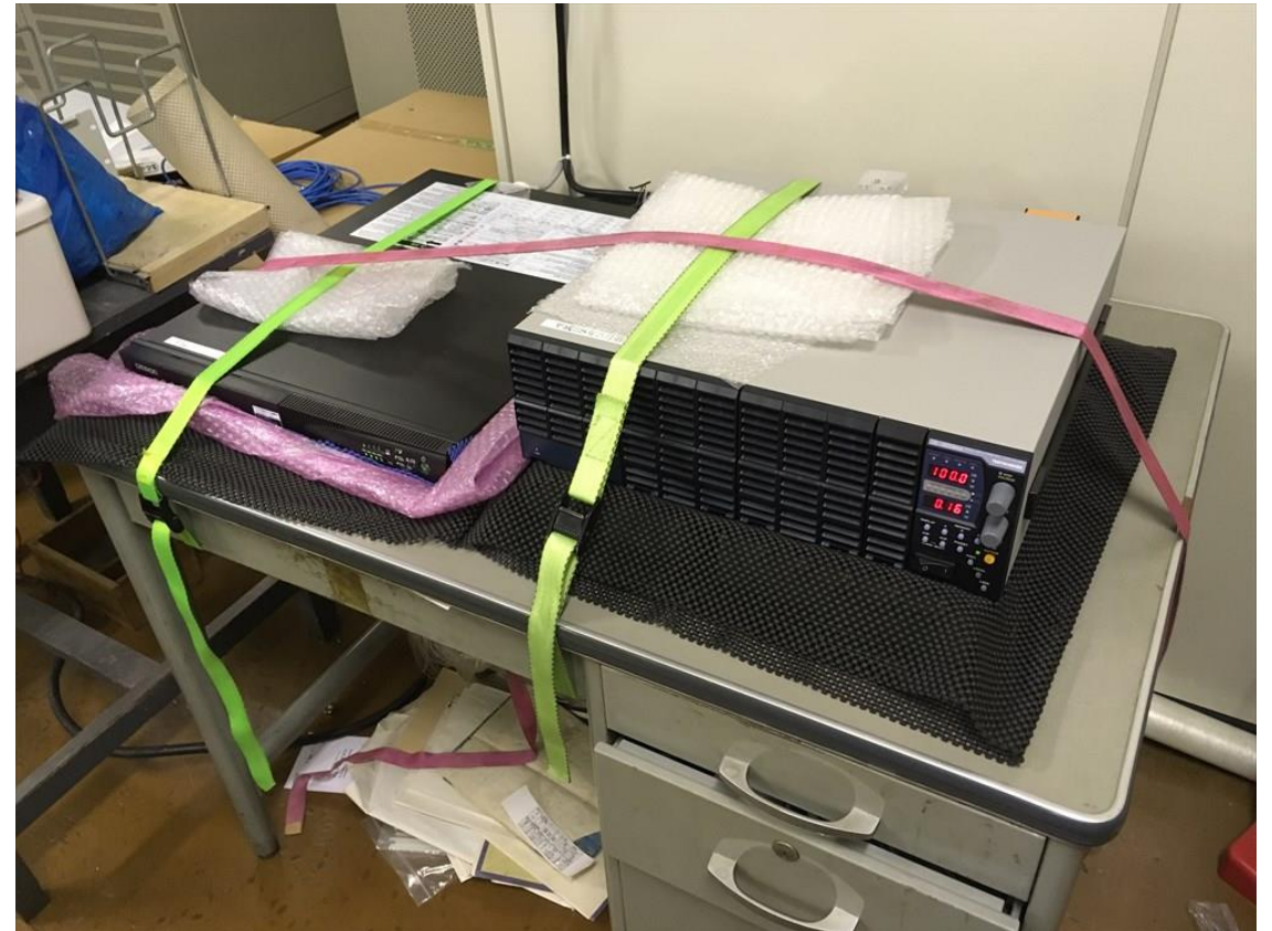
左:UPS 右:直流電源装置
