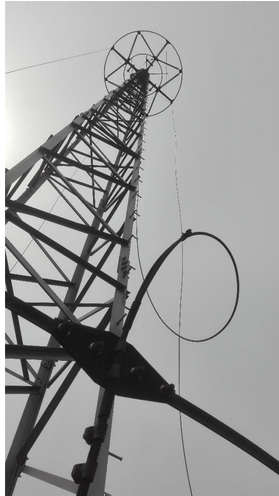
ダウンリード破損
