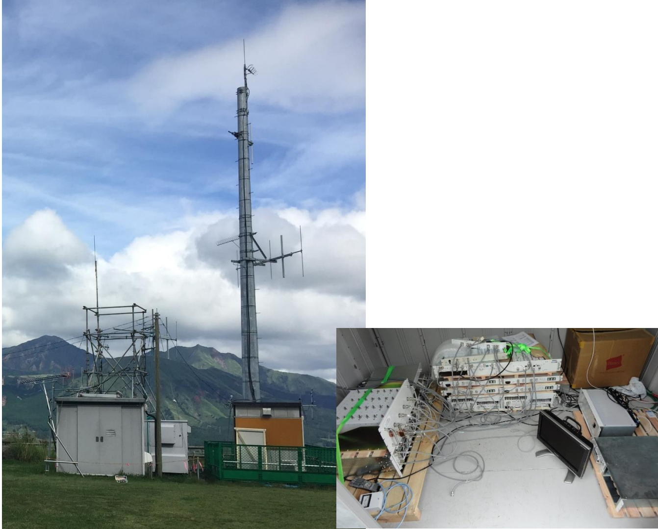
観音桜台の仮設中継局と中継設備
