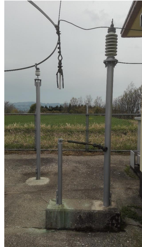
支持直管碍子破損
