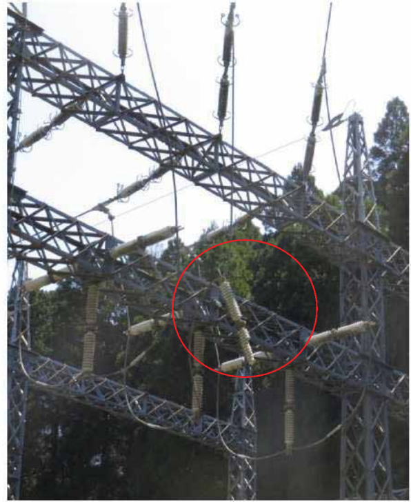
110kV八丁原松原線No.37
