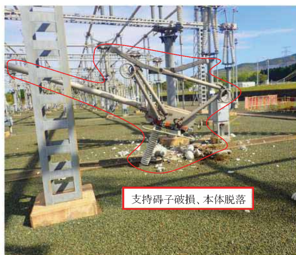
【支持碍子破損、本体脱落】
