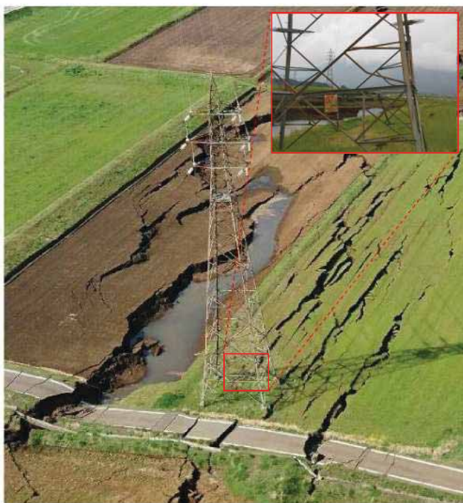
66kV黒川一の宮線No.31
