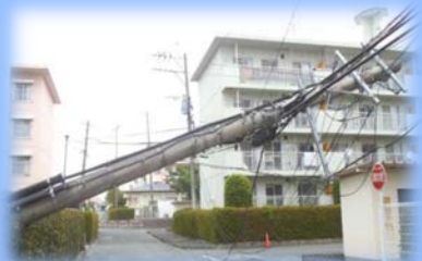
益城町での電柱倒壊
