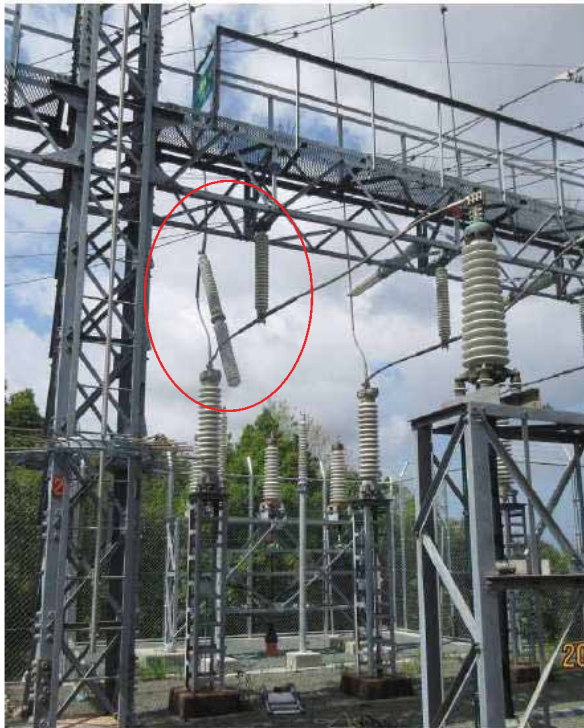
66kV熊本大津線1号線No.2-7
